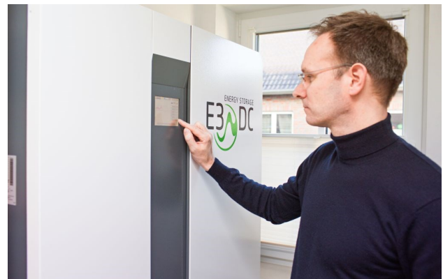
Kontrolliert gerne die Stromflüsse am Hauskraftwerk: Ingenieur Schuler Fotos: Hendrik Lüders
